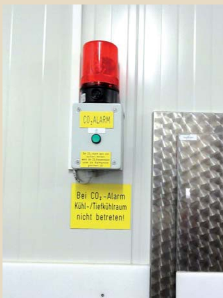
Mögliche Erstickungsgefahr – optische und akustische Gaswarnung im Einsatz vor Kühlräumen mit CO 2 -Umgang Fotos: Seisenberger
